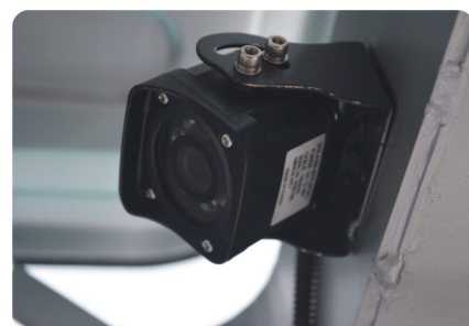
가축 상태 체크용 천장 카메라 설치
