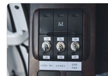
소독시설 및 실내 작업등 작동 스위치
