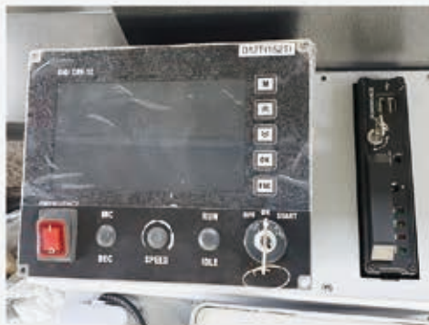
Auxiliary engine control system 보조엔진 컨트롤 시스템
