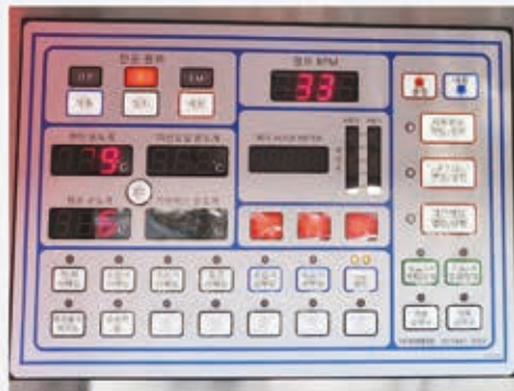
Fire pump control panel(LH/RH) 소방펌프 컨트롤 패널(LH/RH)
