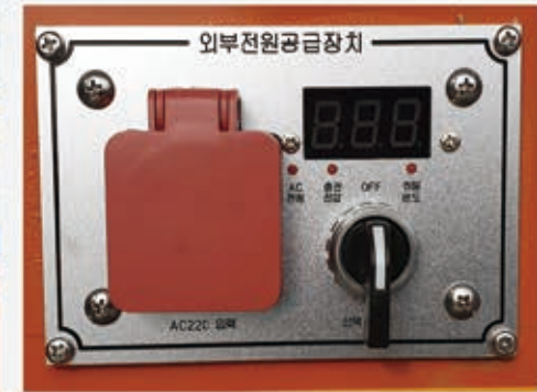
External power supply(220V) 외부 전원 공급장치(220V)
