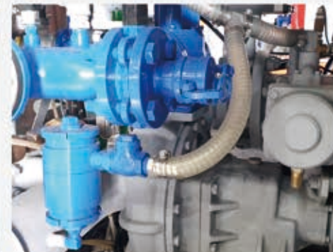
Fire pump water supply and drainage system 소방펌프 급배수 시스템
