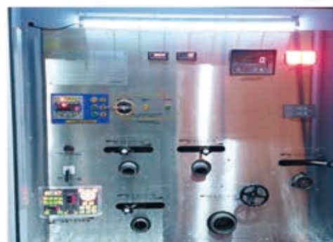
소방펌프 전자식 판넬 Fire pump electronic panel
